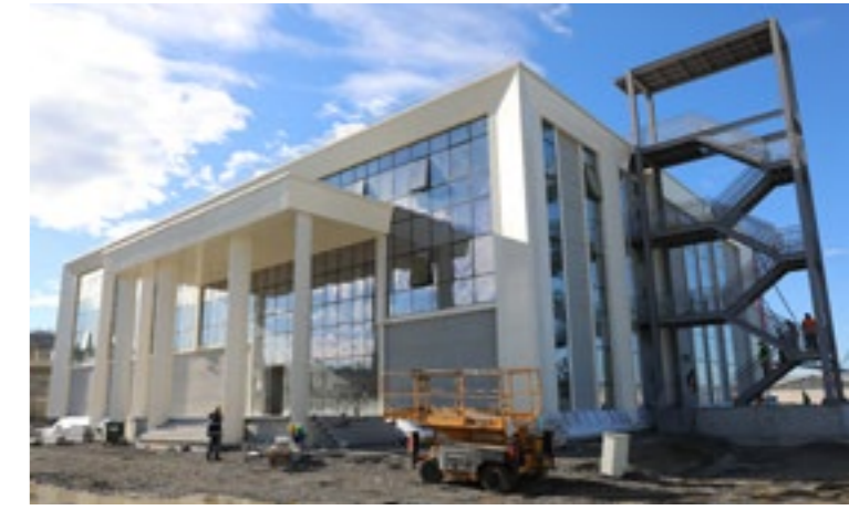
Ana Kontrol Merkezi, Lapseki. Main Control Center, Lapseki.
