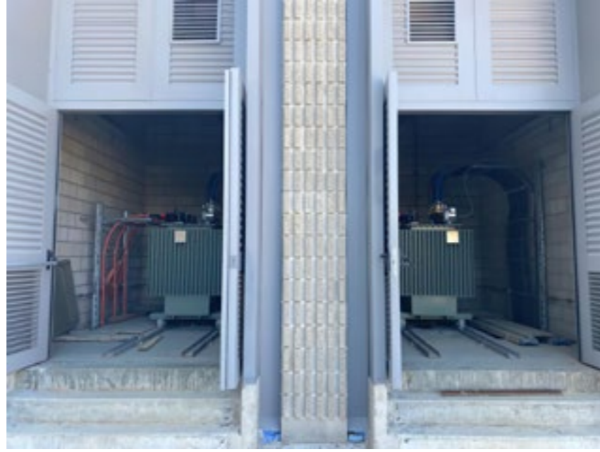
Köprü'nün kalbi olan ana enerji besleme noktaları. Main energy feed points that are the heart of the bridge.
