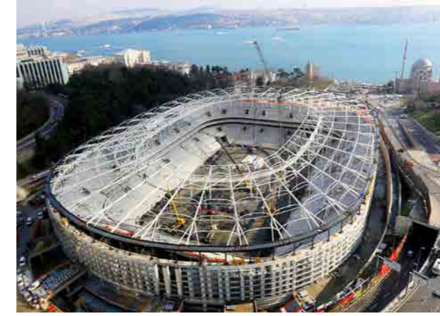
Vodafone Park Stadyumu Çatı Dizaynı - Çatı kaldırma. Vodafone Park Stadium Roof Design - Roof Lifting works.
