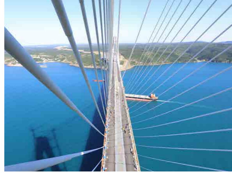
Yavuz Sultan Selim Köprüsü Eğik Askı ve Ardgerme işleri. Yavuz Sultan Selim Bridge / Cable-Stay and Post-Tensioning works
